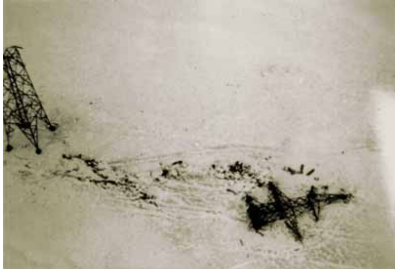
写真 1. 着雪で頭が引きちぎられた鉄塔
