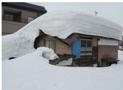
写真 3. 雪荷重で軒先が折られた家屋： 十日町市撮影
