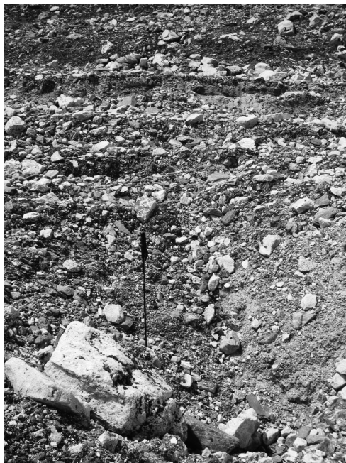
図 4 堤体の排水路左岸側で見られる段差。 ポールの長さは 115 cm.
