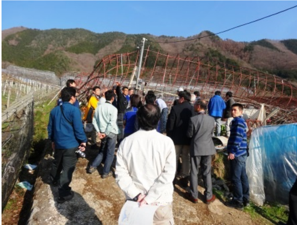
写真 9 . 雪荷重により倒壊した農業ハウスの調査（甲州市塩山下萩原）
