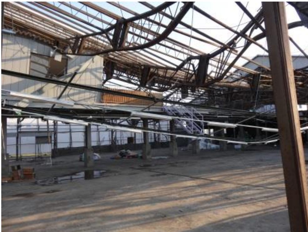
写真 10 . 雪荷重により屋根が大きく変形した果物共撰場（山梨市落合）
