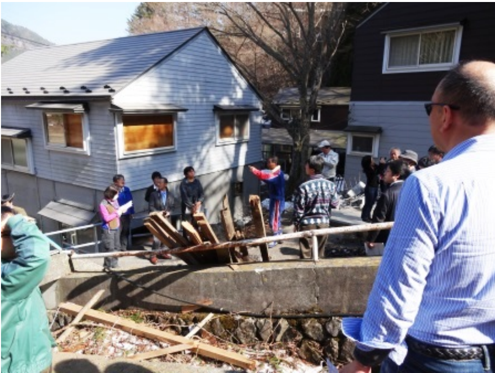
写真 8 . 雪崩による建物被害を受けたキャンプ場の調査 (富士河口湖町精進)
